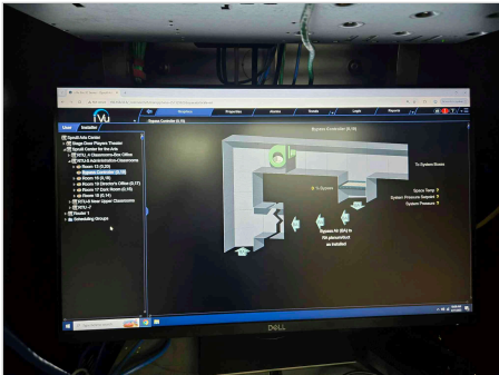
BAS Screen Shot - Bypass Controller.jpg
