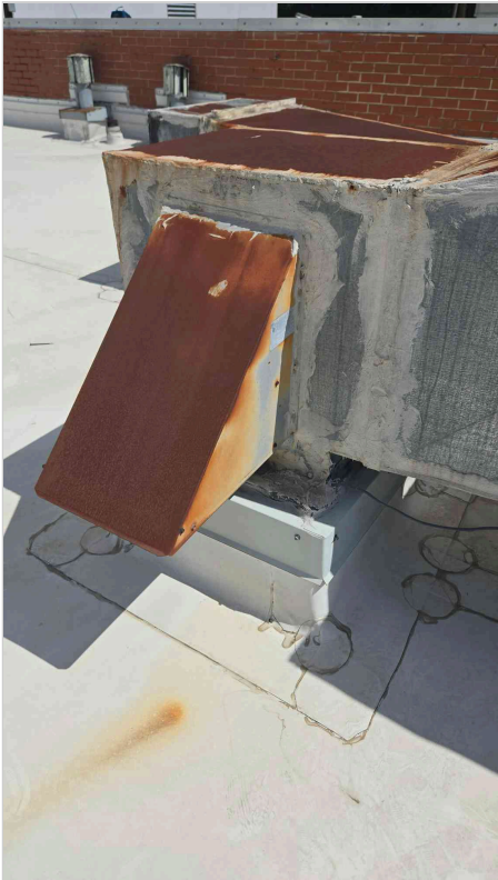
RTU3 OA Intake.jpeg
